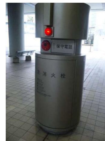
移動式 泡消火栓
